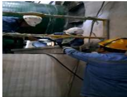
Gambar 13. Pengecekan Sumber Kerusakan
